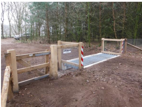
Complete opstelling met klappoort
